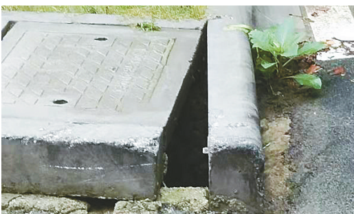
井冈山北路德国小镇2号楼南侧, 井盖移位。
