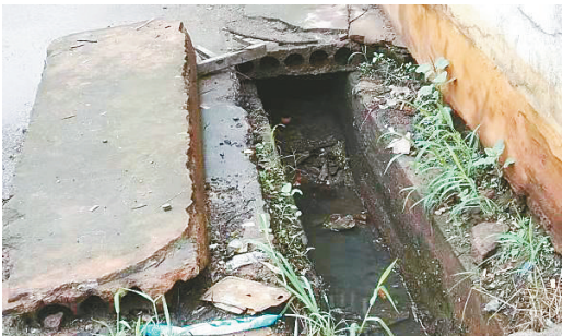
柳江路与交通南路交叉口向东约100米路北,污水盖板移位。
