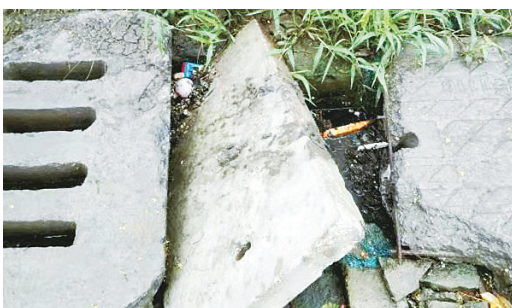
交通南路与银江路交叉口向北约50米路东,污水盖板移位。
