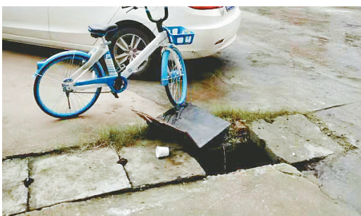
辽河路与巴山路交叉口向东约50米路北,污水盖板缺失。
