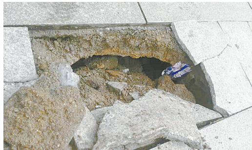
柳江路蓝湖北区南门面房前,地砖破损。
