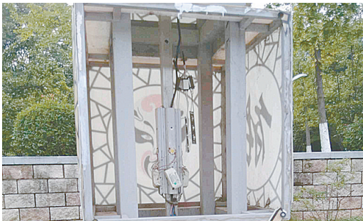
沙河北堤与泰山北路交叉口向东约100米路南，景观灯破损。
