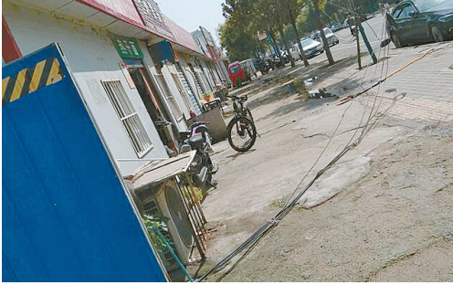
汉江路与骊山路交叉口向东约70米路北，通信线缆脱落。
