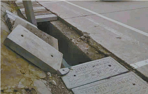
延河路45号门前南侧，路面排水沟盖板移位。
