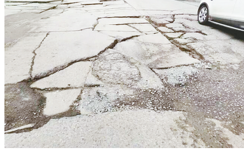
樟江东路(衡山路至燕山南路段),路面损坏严重。
