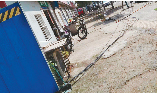
汉江路与颍山路交叉口向东约70米路北,线缆落地。
