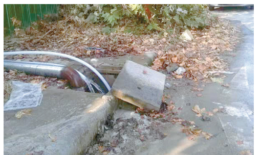
王屋山路与柳江路交叉口向北约300米路西,污水井盖移位。
