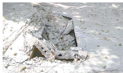
邱山路与淞江路交叉口向北约50米路东,盖板破损下陷。
