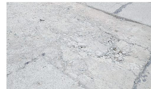
亚泰名仕公馆,路面破损严重。
