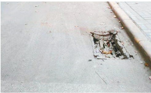
八一路与团结路交叉口向东约60米路南,主路面上井盖破损。
