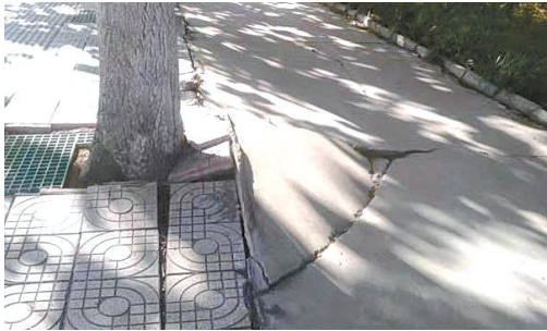
人民东路与燕山南路交叉口向东约250米路北，人行道破损。
