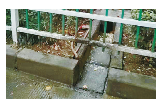
柳巷路与嵩山南路交叉口向西约170米路北，商户乱倒泔水。
