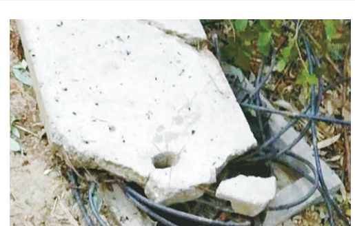
泰山南路与金江路交叉口向南约50米路东，井盖破损。
