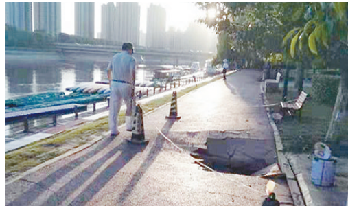
沙澧河风景区一处路面塌陷。
