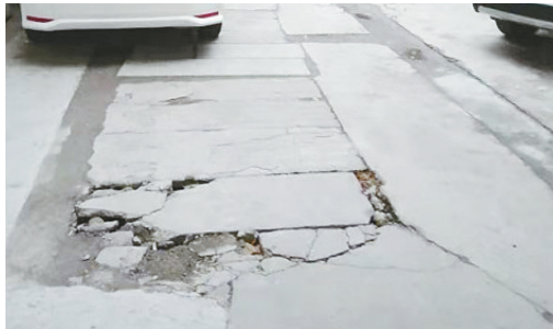
交通北路与黄河中路交叉口向北约30米路东，下水道盖板破损。
