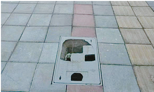
玉河路与千山路交叉口附近，窨井盖破损。
