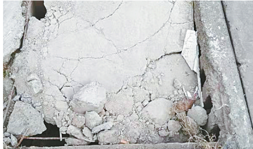
衡山路与漓江路交叉口,东方恒星苑小区六号楼二单元门前井盖破损。
