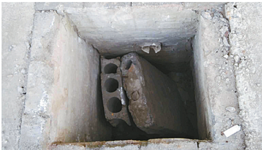
嫩江路与太白山北路交叉口向西约200米路南，盖板掉入井内。
