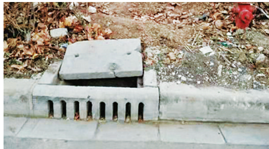
庐山路与漯河路交叉口向北约60米路东，井盖移位。
