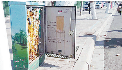
黄河路与解放路交叉口向西约60米路北，通信交接箱门一直开着。
