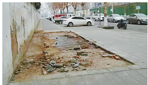
嫩江路和黄山路交叉口附近，人行道破损。
