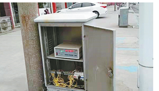
漓江路与香山路交叉口附近，交通信号灯控制柜门未锁，不安全。
