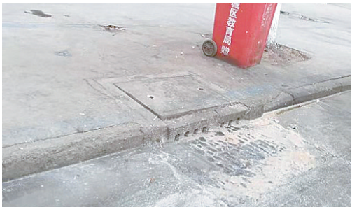
峨眉山路与柳江路交叉口向北约80米路东，下水道口淤堵。
