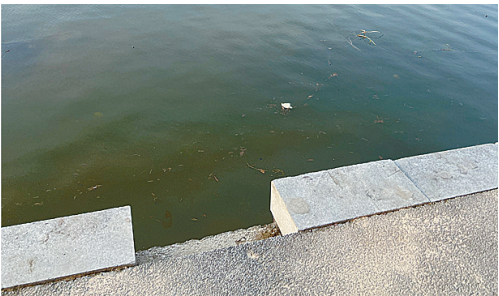
沙澧河景区老虎头南岸河堤，条石松动脱落，有安全隐患。
