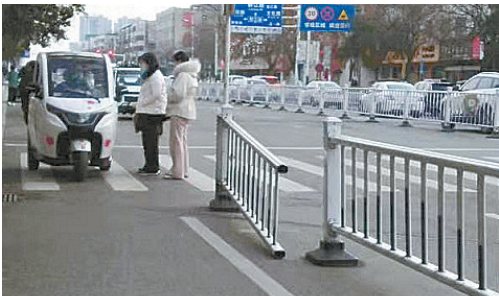
交通南路与建新路交叉口向南约70米路东，交通护栏脱落。
