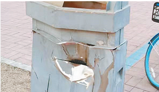
沙北路与支六路交叉口西南角，景观灯破损。
