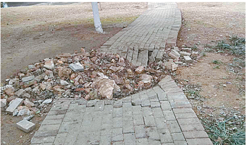
澧河南堤与太行山南路交叉口向东约20米路北，路面塌陷。
