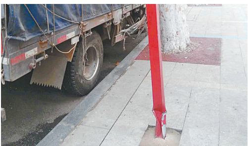
解放南路与湘江东路交叉口向南约90米路西,宣传栏底部损坏。
