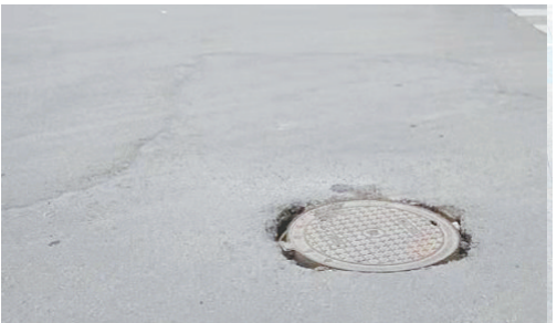
人民东路与银鸽路交叉口,窨井盖下陷。
