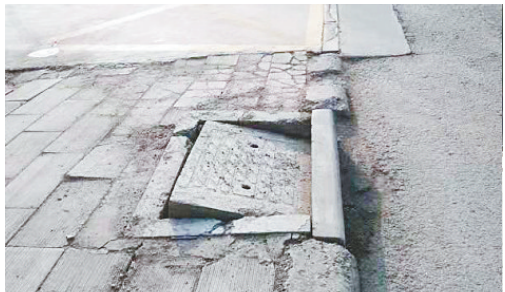
湘江西路与创业路交叉口向西约150米路南,窨井盖下陷。
