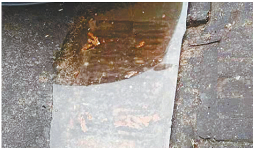
马路街与友爱街交叉口向东约30米路南，下水道堵塞。
