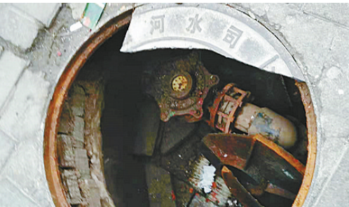
祁山路与黄河中路交叉口，井盖破损。
