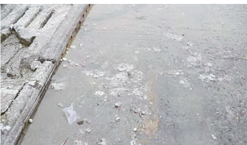
太行山路过河花园小区门前，下水道堵塞，污水流到路上。
