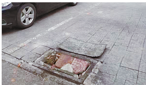
和平街与马路街交叉口东南角，井盖破损缺失。
