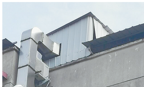
市水利局家属院,有人在楼顶搭建铁皮房。
