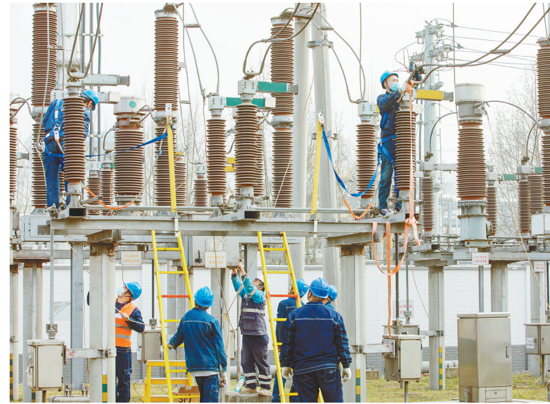
近日,国网漯河供电公司启动电力春检工作。图为3月14日,工作人员在位于舞阳县的110千伏双庙变电站开展检修。
