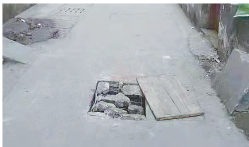
八一路与团结路交叉口向东南约80米路南，窨井盖破损。
