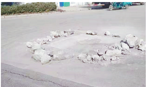
人民东路与庐山路交叉口向东南约50米路北，施工垃圾未清理。
