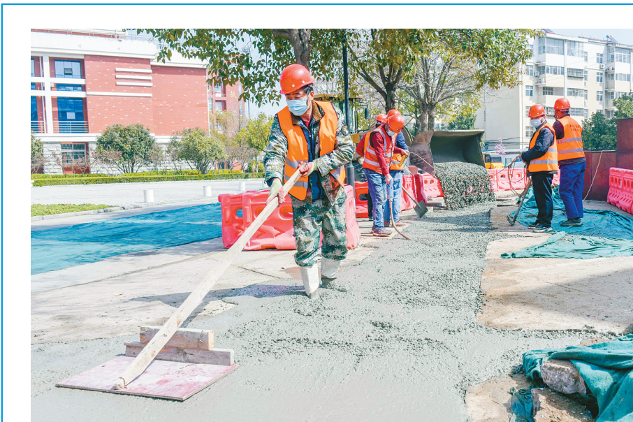
3月18日,施工工人正在市委党校开展雨污分流施工作业。今年汛期前,我市将完成太行山南路、湘江路等路段和京广铁路以东、太行山路以东等区域的雨污分流工程建设任务。 本报记者 焦海洋 摄
