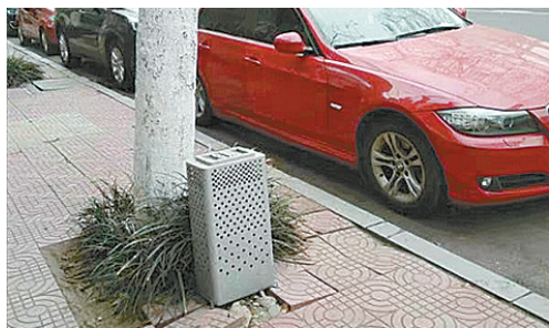
黄山路与洪河路交叉口向南约50米路东,暖气排气口罩底部损坏。
