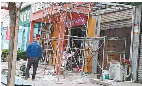
嵩阳路与清江路交叉口向北70米路东,临街门店装修无围挡。
