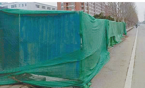
桂江路与太白山路交叉口向西70米路南,施工围挡无占道审批公示牌、撤挡倒计时牌。
