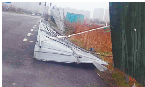
牡丹江路与龙江东路之间一在建道路西侧,施工围挡倒地。
