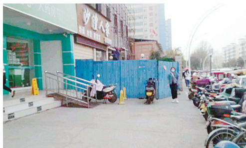
海河路与巴山路交叉口向西30米路南,临街门店围挡无占道审批公示牌、撤挡倒计时牌。
