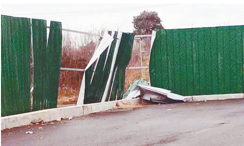
许慎路与日月潭路交叉口南侧,围挡损坏。
