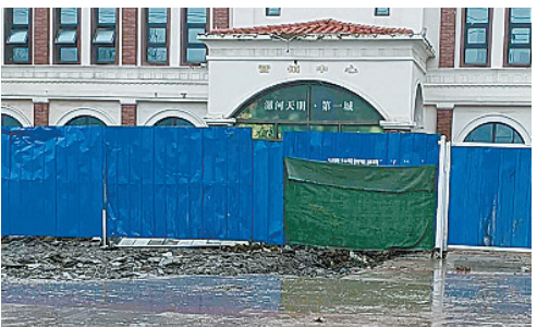
中山北路与淞江路交叉口向南约75米路东，天明第一城小区售楼部围挡无占道审批公示牌和撤挡倒计时牌。
