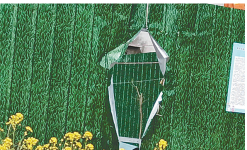
庐山路与渭河路交叉口向南约30米路西，围挡破损。
