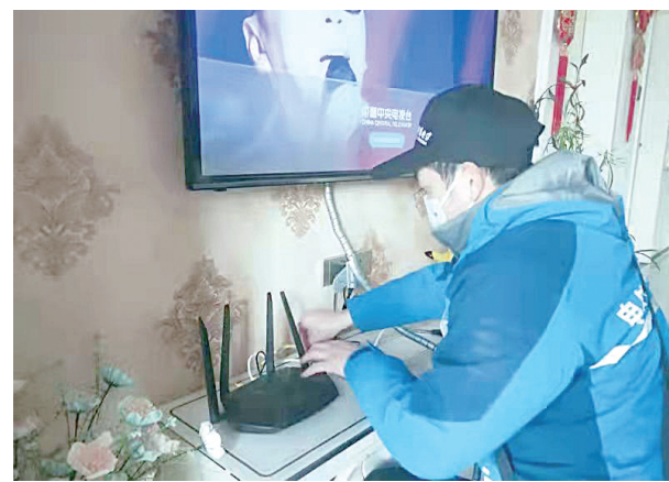
千兆专属工程师为用户提供束线管整理美化线路。
