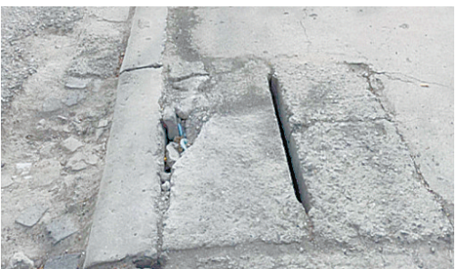
淞江路与太白山北路交叉口向西约100米路南,盖板破损。
