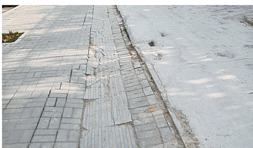
香山路与滦河路交叉口向南30米至120米之间,人行道地砖凹陷破损。
