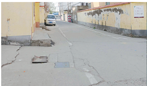
湘江西路与太行山南路交叉口向东约100米路北,井盖翘起。
