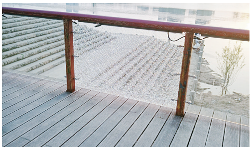
云翠山路与洋河路交叉路口向北约90米，游园内护栏玻璃破损。
