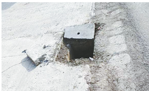
汇丰街与白云山南路交叉路口向西约80米路北，井盖破损。
