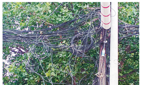
解放南路与金江路交叉口西南角，通信线缆凌乱。
