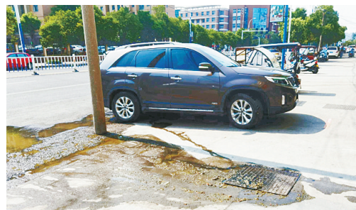
祁山路北段，下水道堵塞，污水外溢。
