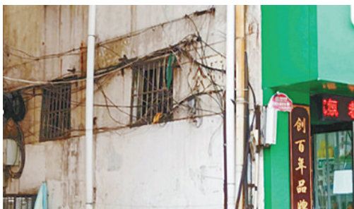
交通南路与老街交叉口向北约50米路东，线缆凌乱。
