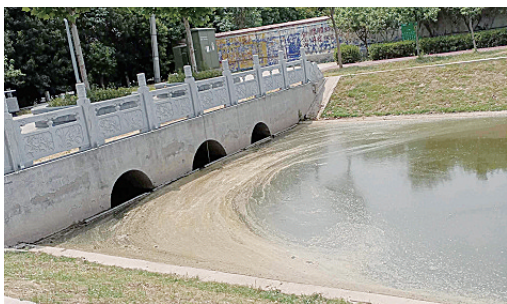
幸福渠路与白云山北路交叉口向西约10米路南，幸福渠水里有漂浮物。
