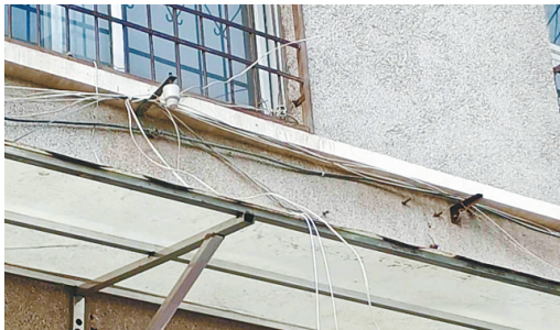
建设路与文化路交叉口向西约120米路北,临街楼上电线凌乱。
