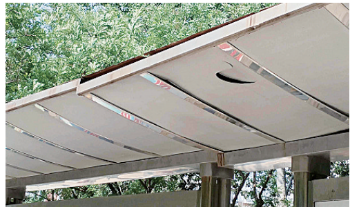
金山北路与淞江路交叉口向南约120米路东,公交车停靠点顶棚破损。
