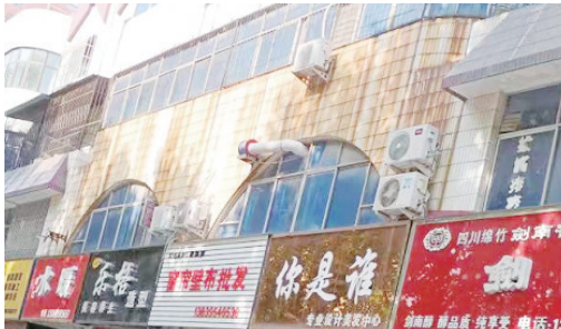
解放南路与万顺街交叉口北侧路西，临街楼外立面不洁。
