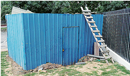
嘉陵江路与王屋山路交叉口向西侧约120米路南，施工围挡无撤除倒计时牌、审批公示牌。
