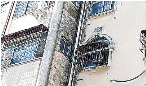
滨河东路与金山南路交叉口西侧路南，临街楼外立面不洁。
