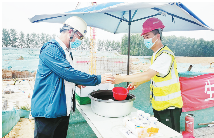
连日来,我市持续高温。6月9日,在沙澧河二期澧河景观工程和澧河上游控制闸工程施工现场,工程项目部工作人员为工人送去绿豆汤等消暑物品。 本报记者 焦靖摄
