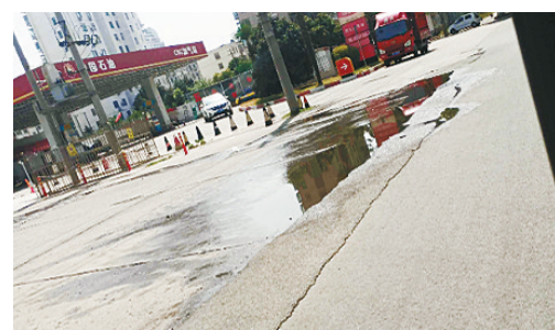
淞江路与泰山北路交叉口附近,下水道堵塞,污水外溢。
