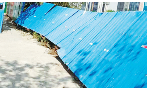
柳江路丹霞山路交叉口向西约60米路北，围挡歪倒。
