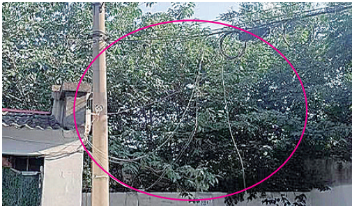
湘江西路与嵩山南路交叉口向东约100米路南，线缆凌乱。
