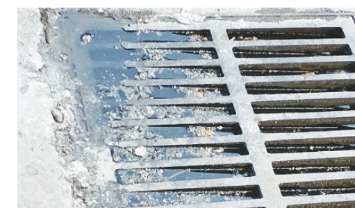
中山北路与渭河路交叉口附近,下水道堵塞。
