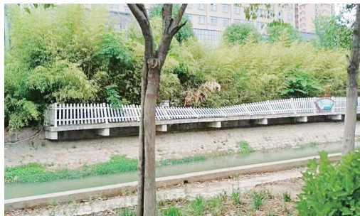
黄河东路与桐柏山路交叉口向东约20米路北，护栏倾斜。
