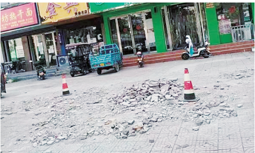
五一路与金江路交叉口向北约200米路东，施工后未将现场清理干净。
