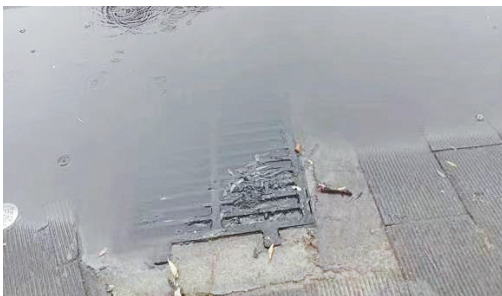
淞江路与嵩山东路交叉口附近,下水道堵塞。
