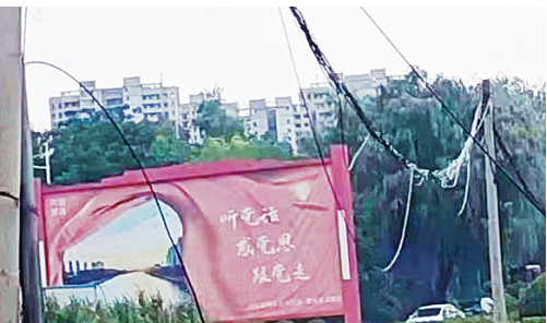
邱山路与龙江西路交叉口附近,线缆垂落。
