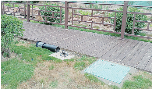
韶山南路与赣江路交叉口向北约150米路东,绿化带内地灯倒地。
