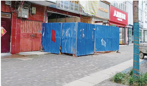
辽河路与华山路交叉口向东约50米路南,临街门店施工围挡无占道审批公示牌。
