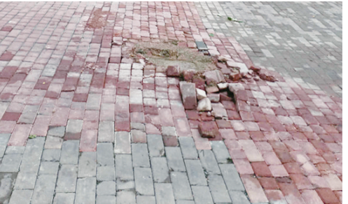
九龙山路与月湾湖东路交叉口向南约80米路东,地砖松动破损。
