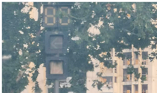
太行山路和湘江路交叉口，交通信号灯不亮。
