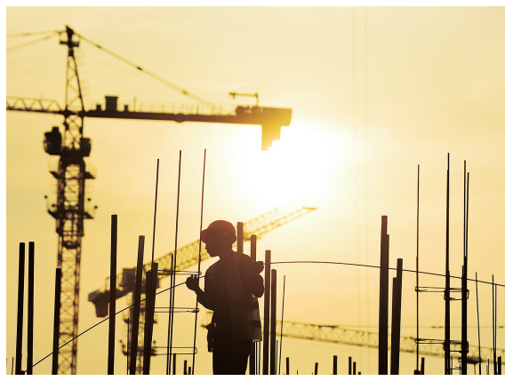
7月12日,工人在江苏无锡经开区的一处住宅小区建设工地上施工。 新华社发 还月亮 摄
