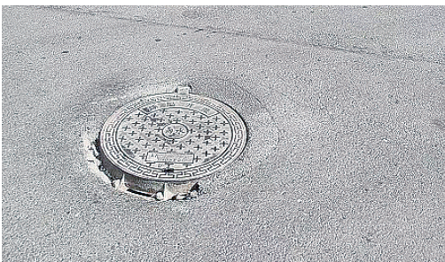
庐山路与漓江路交叉口向北约5米路西,井盖周边破损。
