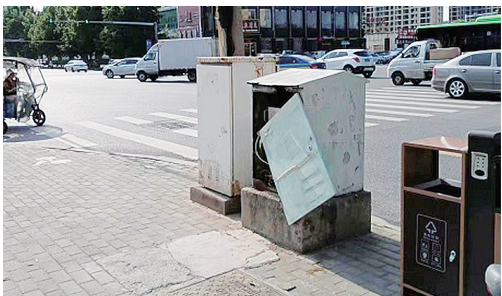
人民东路与衡山路交叉口向东约10米路南,交通信号设施箱损坏。
