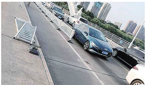
泰山路与沙河北堤交叉口向南约220米路西,交通护栏破损。
