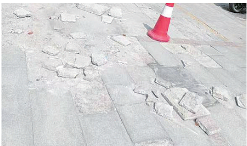
滨河东路与光明路交叉口向西约150米路北,施工后现场未清理干净。
