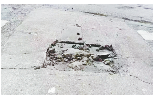
辽河路与尚德路交叉口向东约90米路北，污水盖板破损。
