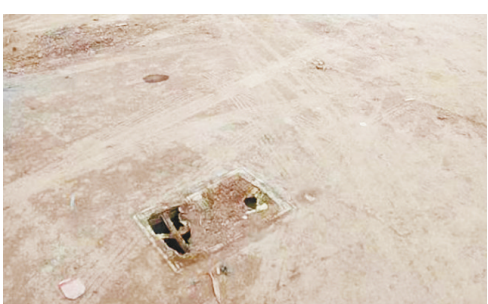
黄河东路与香山路交叉口向东约150米路北，井盖破损。
