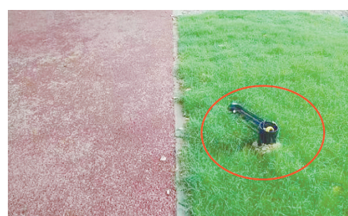
黄河东路与燕山北路交叉口向东约20米路北，地灯破损。
