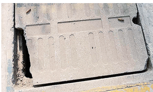
泰山南路与金江路交叉口向北约160米路西,井盖破损。
