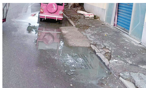
戏楼后街与民主路交叉口向北约60米路东,下水道堵塞。
