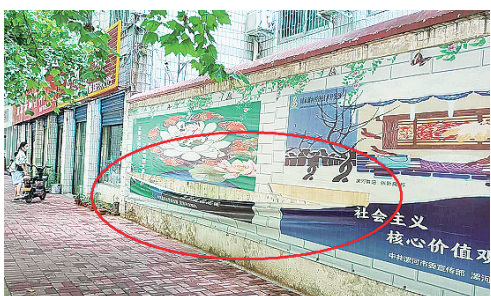
解放南路与金江路交叉口向南约170米路西,公益广告破损。
